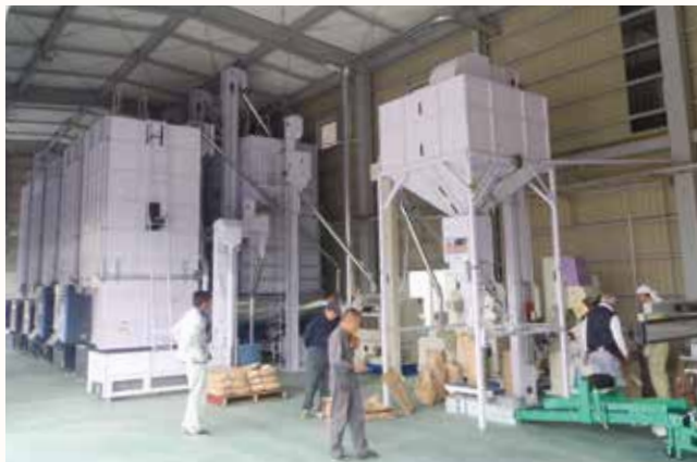
▲乾燥機 5 基、粗粗選機 1 基、粉摺機 1 基などを設置。
