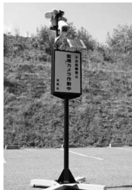
導入した監視カメラ
