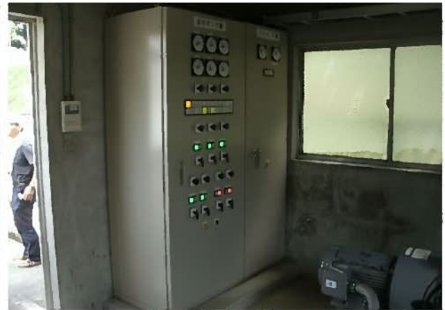
計装盤及びポンプ操作盤
