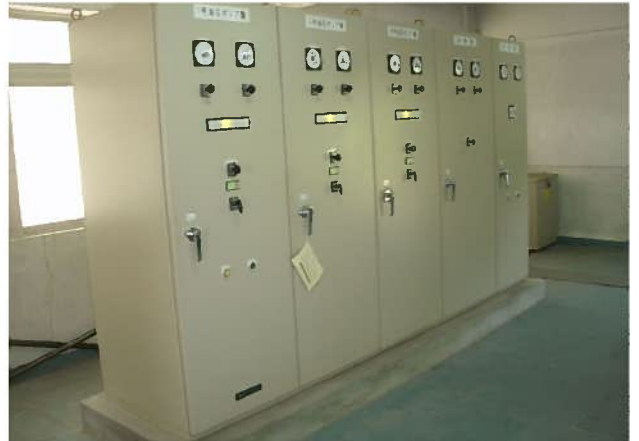
計装盤及びポンプ操作盤
