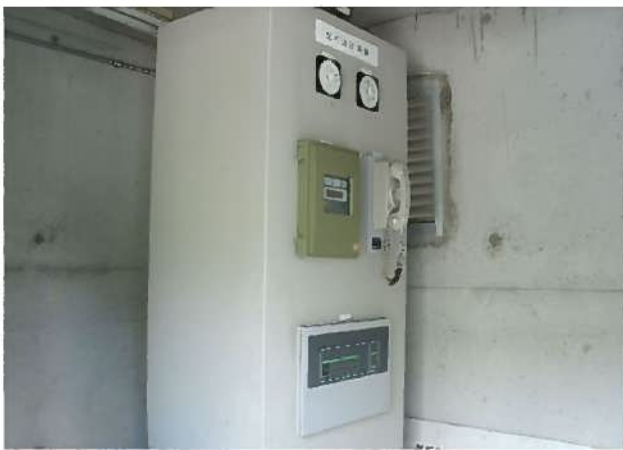
配水池計装盤
