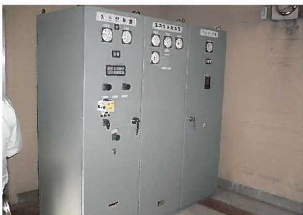
配電盤・テレメータ盤等
