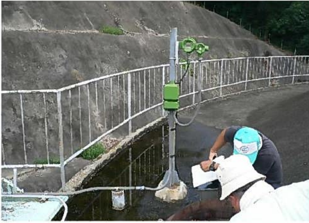
配水池上部・水位計
