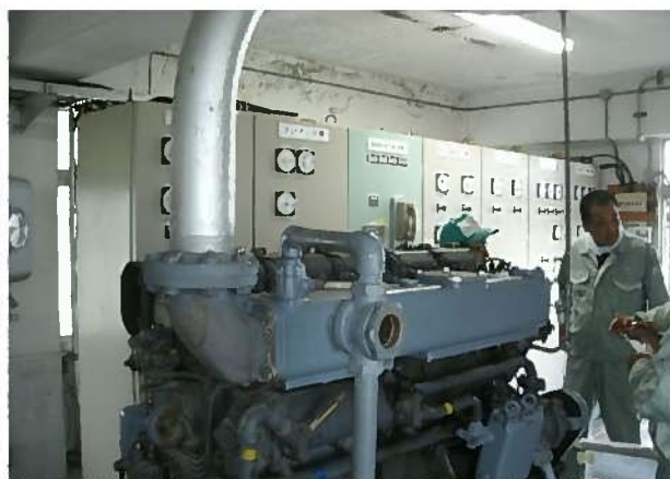
発電機、計装盤及びポンプ操作盤
