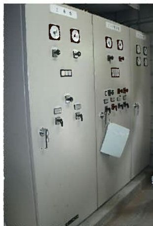
テレメータ盤、ポンプ制御盤等
