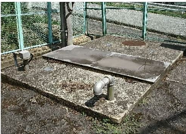
水位調整弁室
