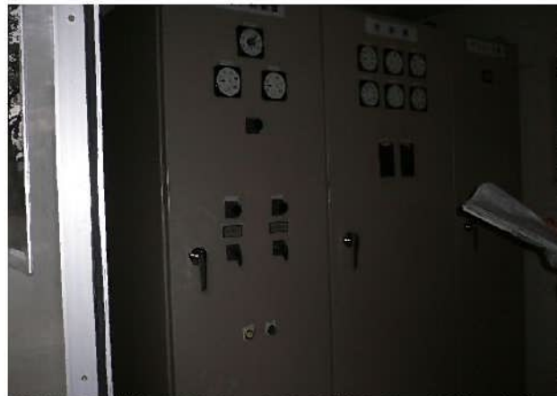
計装盤・テレメータ盤等
