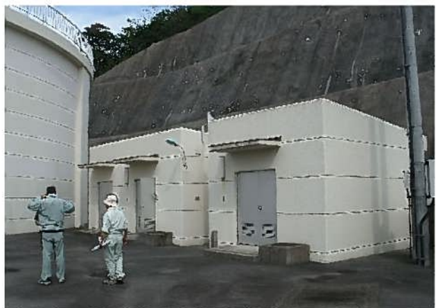
電気・薬注室
