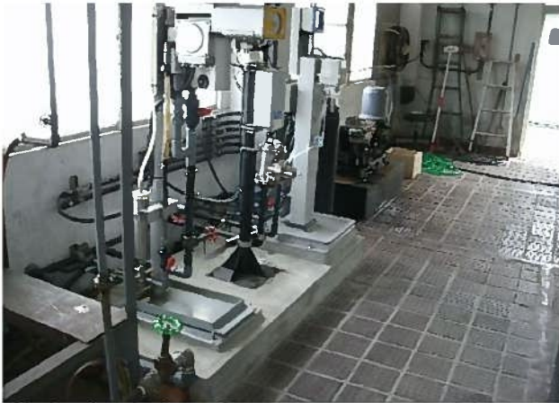
計装設備 (PH計、濁度計、残塩計)
