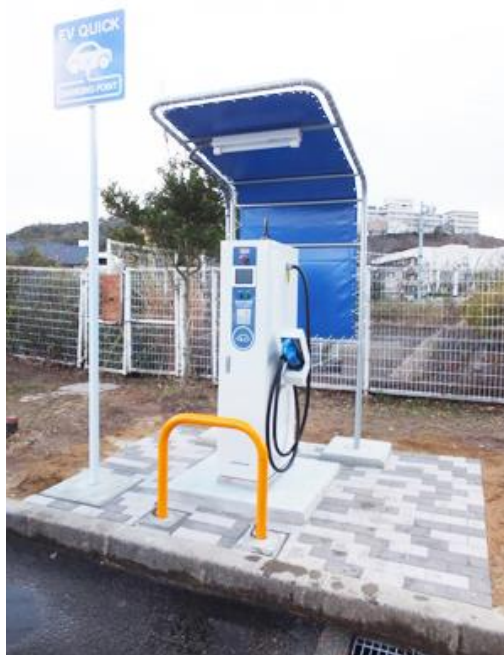
電気自動車 急速充電器
