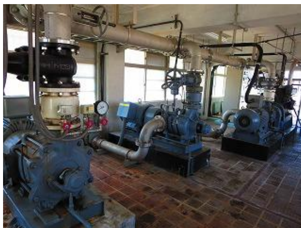
ポンプ場内部
