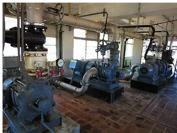
ポンプ場内部
