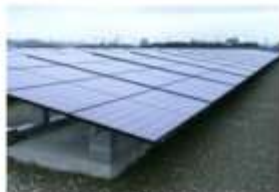
太陽光発電施設の設置例
