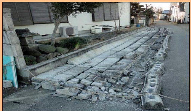
例)ブロック塀の倒壊
