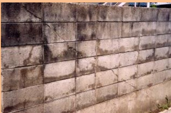
例)ブロック塀のひび割れ
