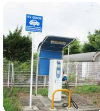
市役所駐車場に設置された急速充電器
