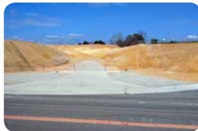
鶉野飛行場線の起点、東笠原町付近。造成工事が進む。 (令和 4 年 4 月 12 日撮影)
