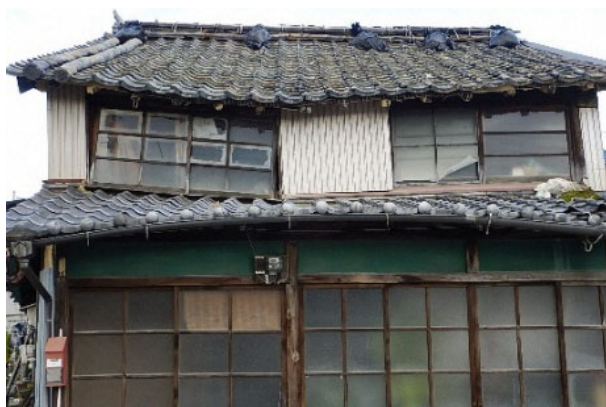
増加する危険な空き家
