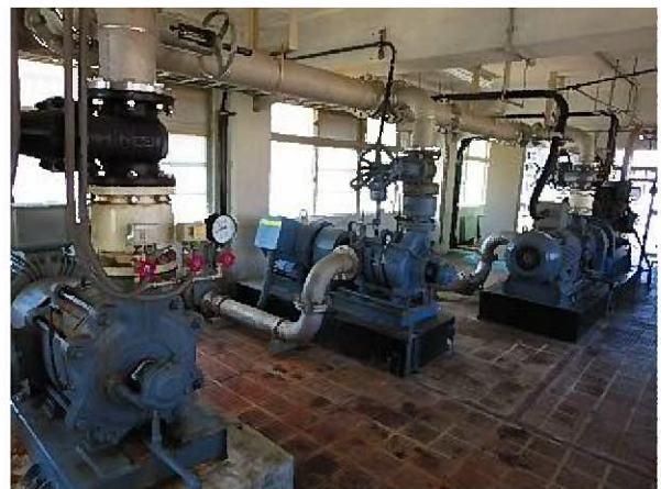
ポンプ場内部
