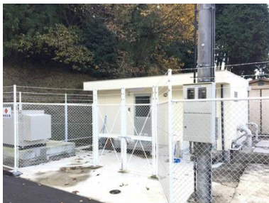
名称 万願寺ポンプ場 建築年月 1979 建築延床面積 19.00 m 2
