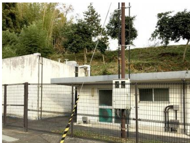
名称 小谷ポンプ場 建築年月 1971 建築延床面積 12.70 m 2
