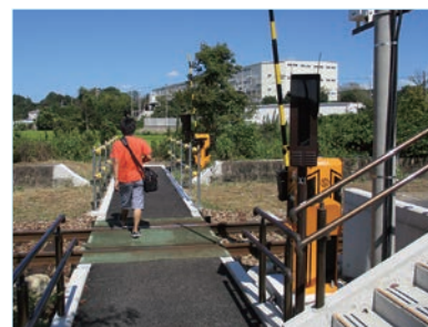
法華口駅構内に設置された歩行者用踏切
